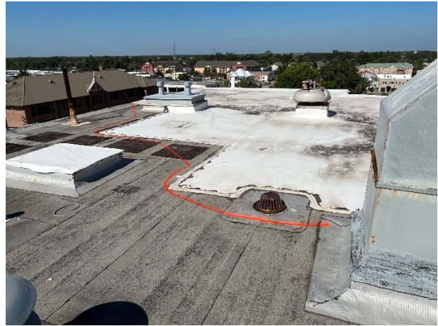
Section A: moisture detected
